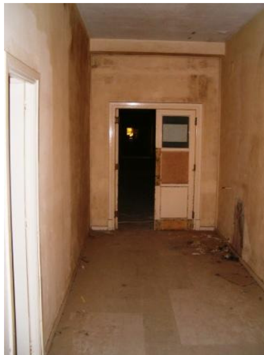
El cambio de temperatura entre las habitaciones es muy habitual en el interior del Hospital
