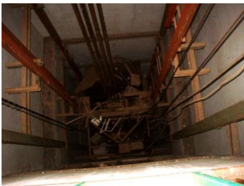
Uno de los ascensores caídos
